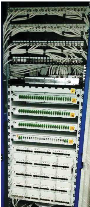
Rysunek 6. Przykładowa szafa 19 cali stojąca w pomieszczeniu technicznym.
