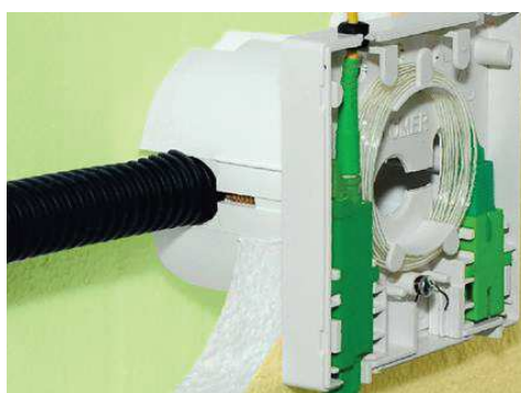
Rysunek 21. Autonomiczne gniazdo optyczne umożliwiające doprowadzenie światłowodu z różnych kierunków.
